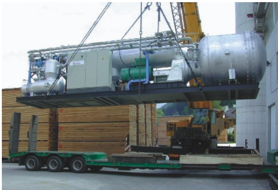
Abbildung 2 Bei der STIA im steirischen Admont wurde eine auf einem Containerrahmen vormontierte ORC-Anlage installiert. Die Anlage hat eine elektrische Nennleistung von 400 kW und ist seit September 1999 in Betrieb.
