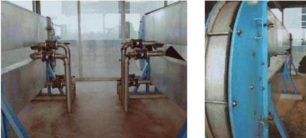
Abbildung 17: Externe Temperierung des Gärgutes mittels Wärmetauscher [Harasek und Tretter (2003)].
