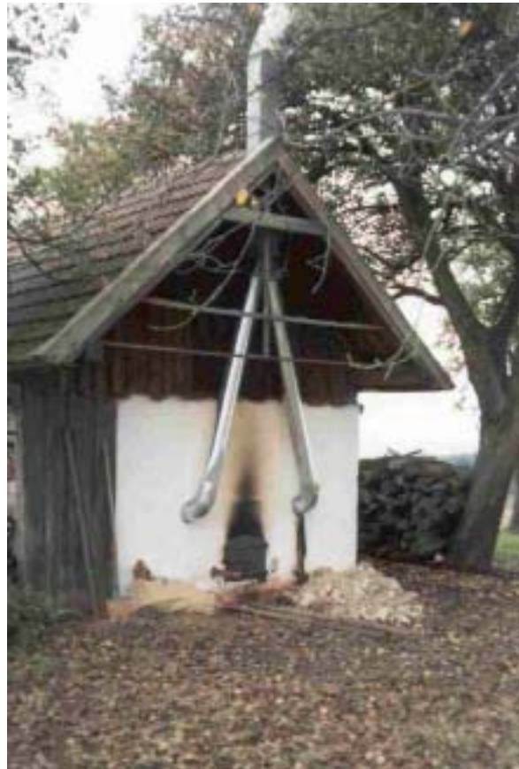
Abbildung 17: Nachträglich eingebauter Rauchrohr-Kamin beim verbesserten Dörrhaus
