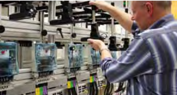
AMIS-Labor Zählerkalibrierung, Foto: Energie AG Oberösterreich
