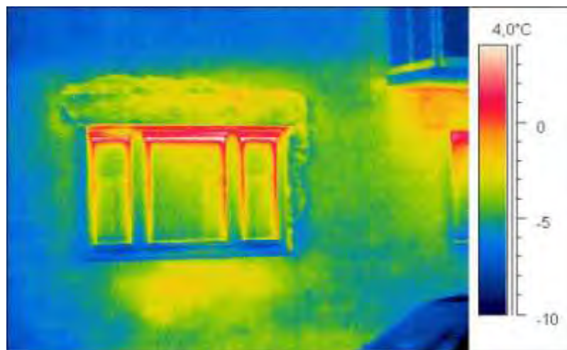
Abb. 4: Thermografieaufnahme eines nicht sanierten Objektes Quelle: Grazer Energieagentur
