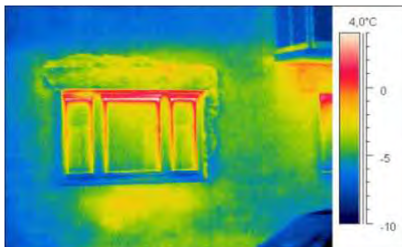
Abb. 8: Thermografieaufnahme eines nicht sanierten Objektes (Quelle: Grazer Energieagentur)
