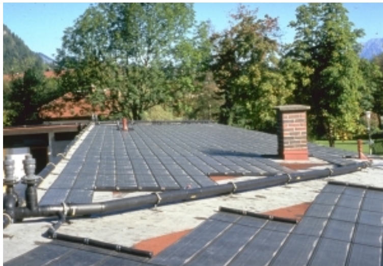
Abb. 4: Kunststoffabsorbermatten zur Beckenwasserwärmung
