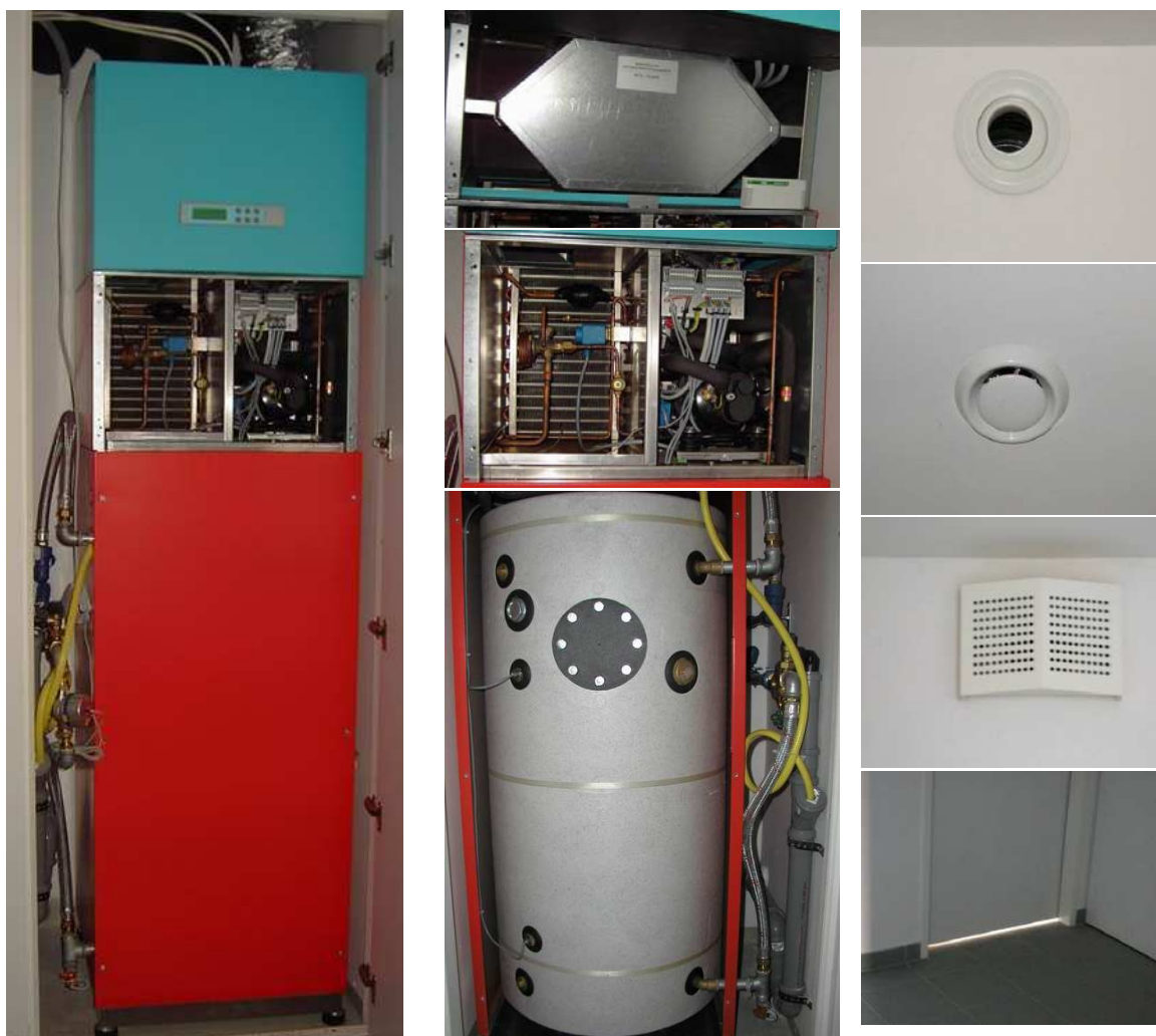
Abbildung 3: Kompaktlüftungsgerät Fa. Drexel&Weiss (links, mitte); Zu,- Abluft, Überströmöffnungen (rechts) [AEE Intec]
