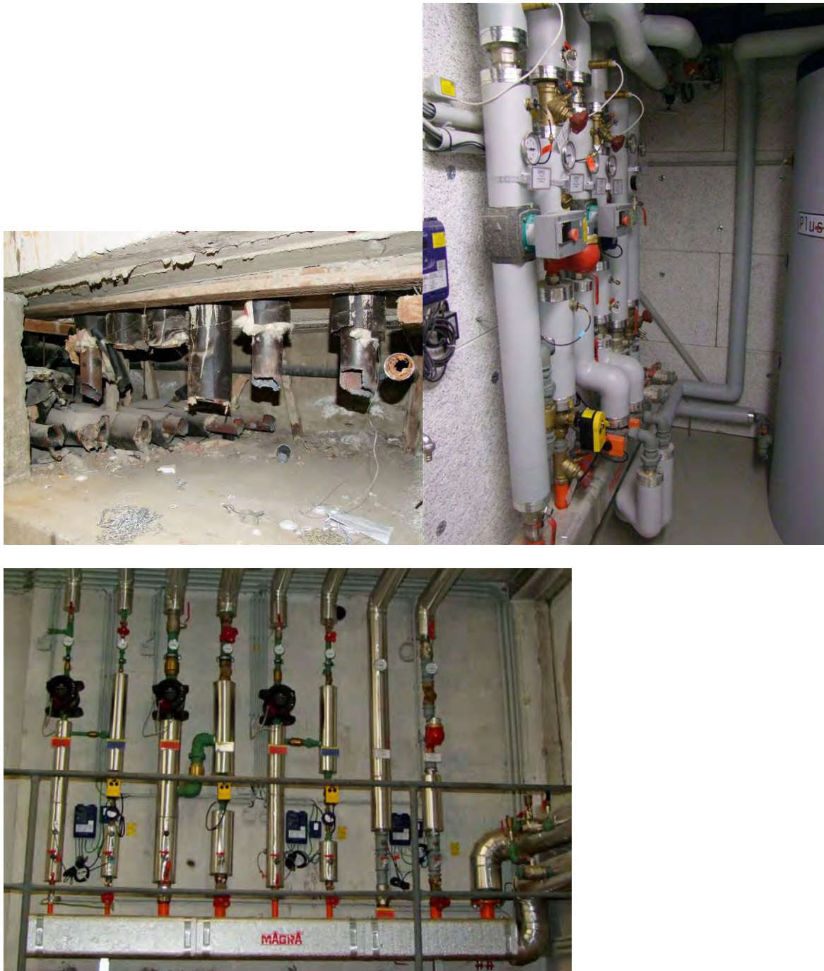
Abbildung 23: Haustechnikverteiler - Alt und Neu
