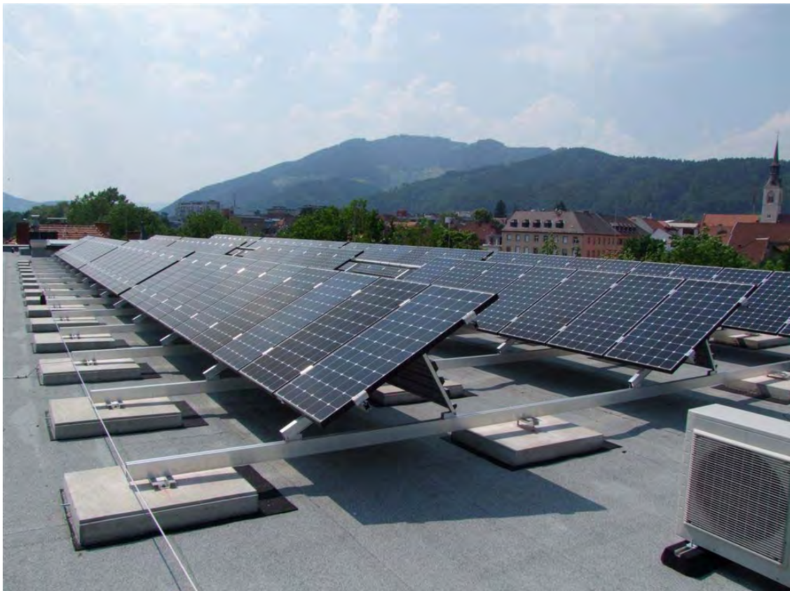
Abbildung 28: PV Module am Dach des Amtshauses (Quelle: Grazer Energieagentur GmbH)
