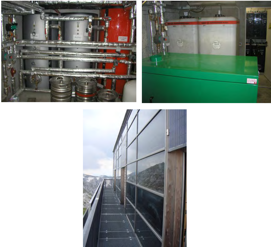
Abbildung 6: links: 3 Pufferspeicher mit je 1200 Liter; rechts: Pflanzenöl BHKW, unten: fassadenintegrierte thermische Solaranlage
