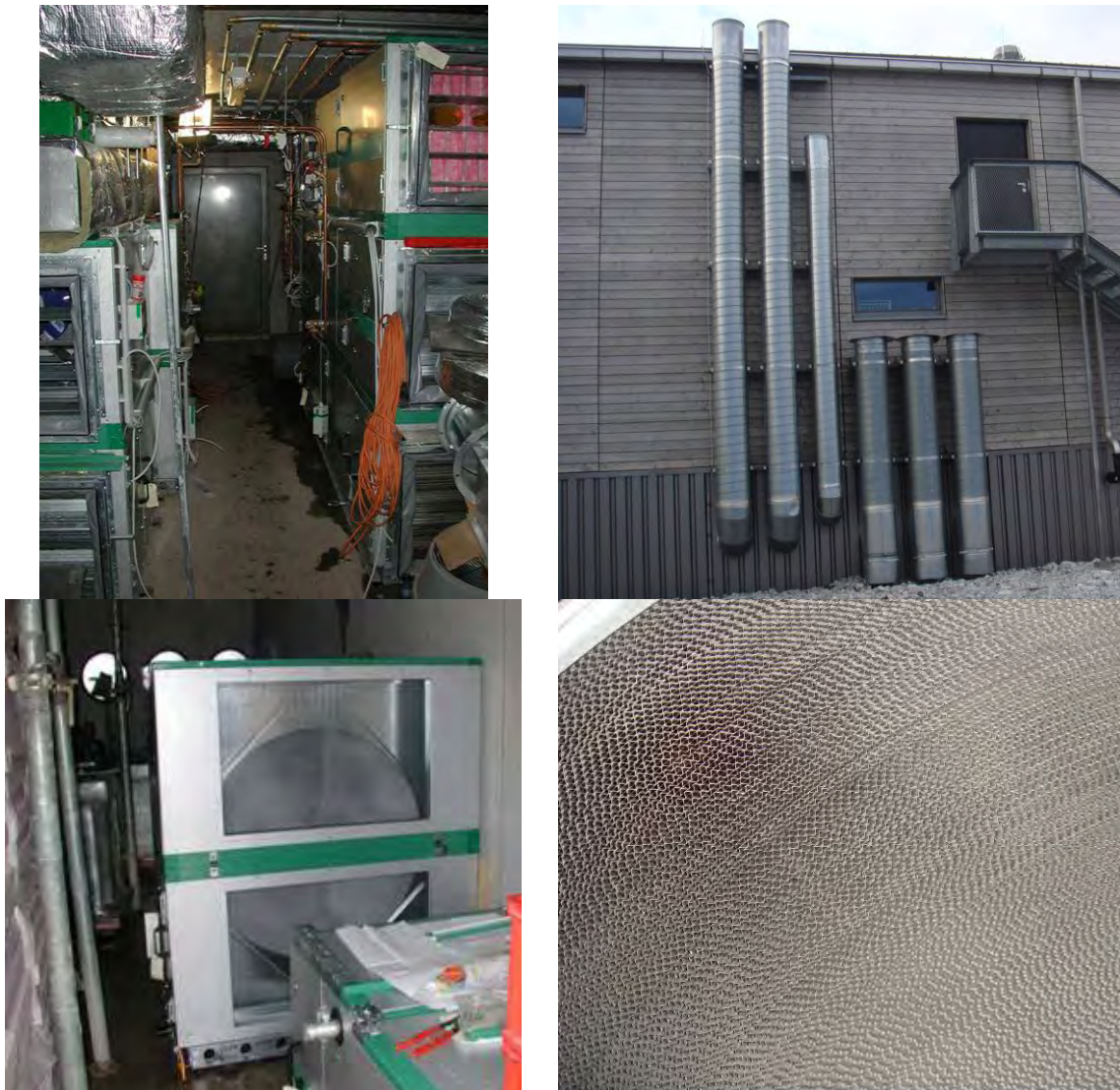
Abbildung 8: links - oben: Lüftungszentrale im Kellergeschoss [bm:vit]; rechts - oben: Frischluftansaugung – Fortluftöffnungen [AEE INTEC], links – unten: Rotationswärmetauscher [bm:vit], rechts – unten: Rotationswärmetauscherrad [AEE INTEC]
