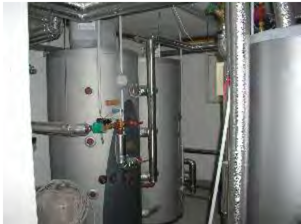
Wärmespeichersystem im Keller Quelle: AEE INTEC
