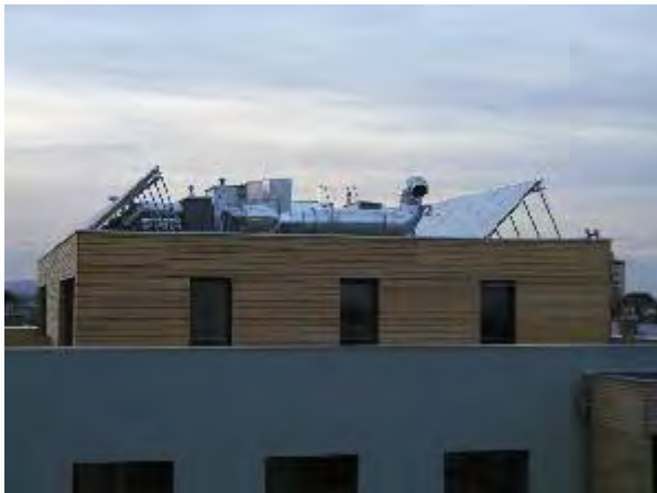
Penthauswohnung mit installierter Haustechnik am Dach Quelle: AEE INTEC
