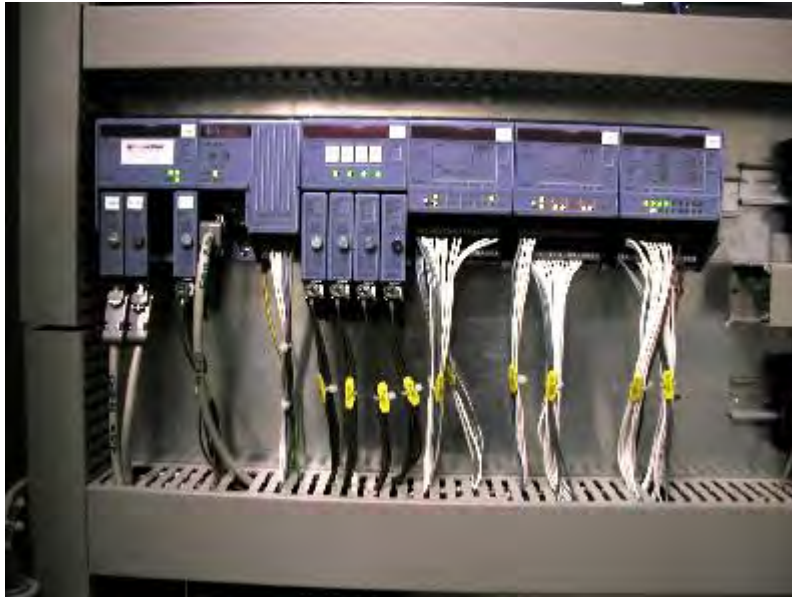
Abbildung 14: Eingebautes Loggersystem (Quelle: AEE INTEC)
