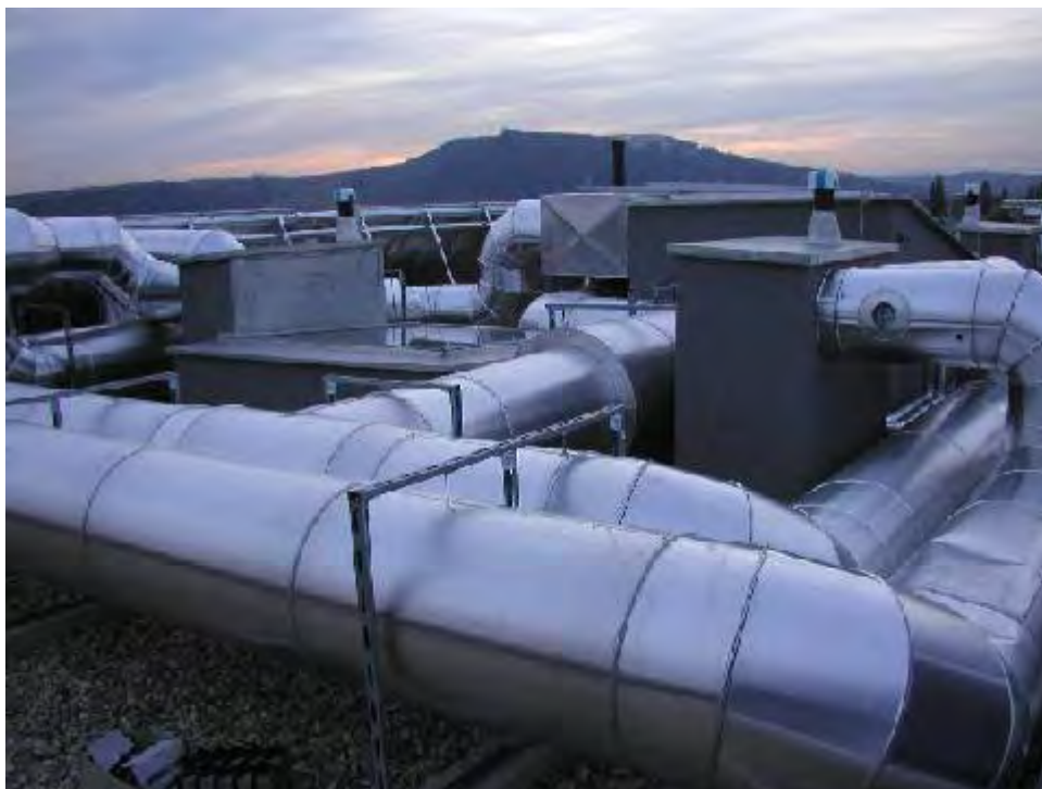
Abbildung 10: Zentrales Lüftungssystem am Dach der Gebäude (Quelle: AEE- INTEC)
