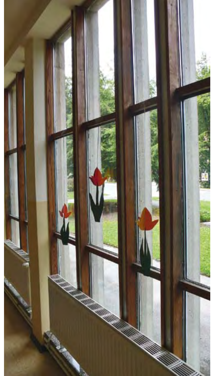
Raumhohe Gangverglasung Bestandsschule – Sanierungsversuch durch vorgesetzte Heizkörper, um die Abstrahlung der Verglasung zu minimieren.
