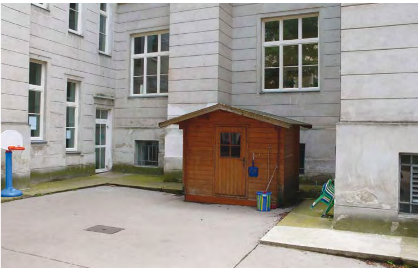
Mehr als erneuerungsbedürftig zeigt sich ein Schulhof der Kleinen: Volksschule Alseggerstraße, 1180 Wien. Foto: Robert Temel
