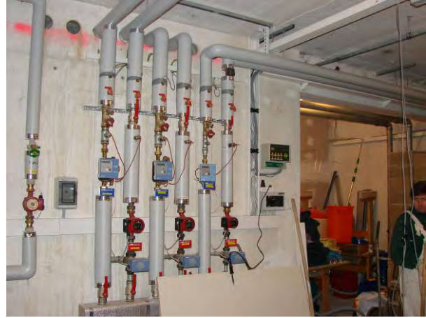
Messstellen und Datenlogger an Heizwärmeverteilung Quelle: AEE Intec
