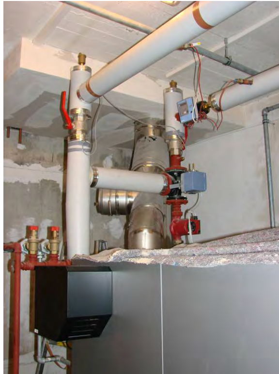
Abbildung 20 Wärmemengenzähler am Heizkessel [AEE INTEC]
