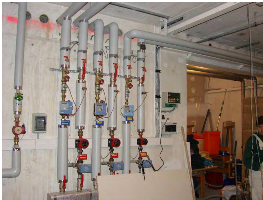
Abbildung 19 Wärmemengenzähler der Heizkreisläufe HS II, PTS und Turnsaal mit Datenlogger [AEE INTEC]
