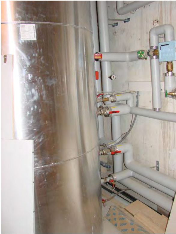
Temperaturmessstellen am Pufferspeicher Quelle: AEE Intec
