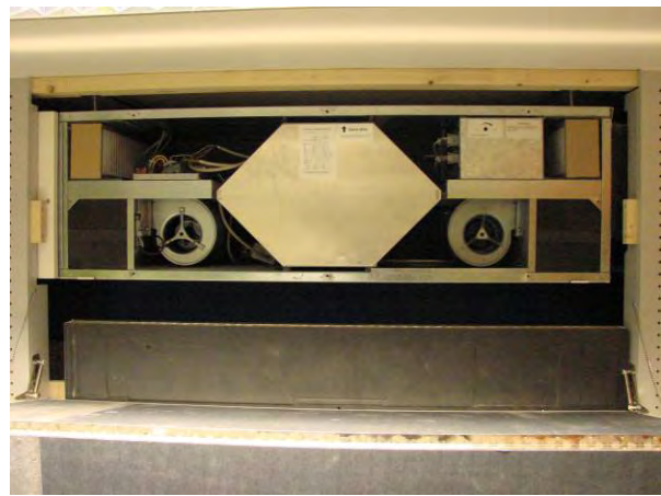
Klassenlüftungsgerät Quelle: AEE Intec
