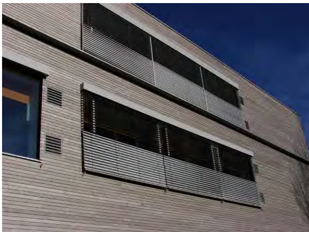
Außenliegende Verschattung, Lüftungsöffnungen Quelle: AEE Intec
