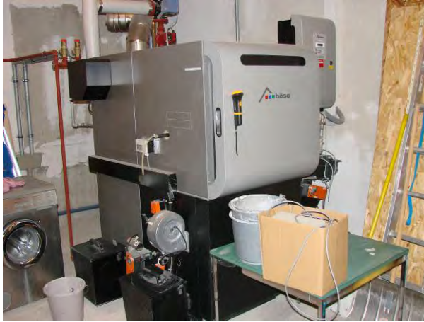
Pelletsessel 110 kW Quelle: AEE Intec
