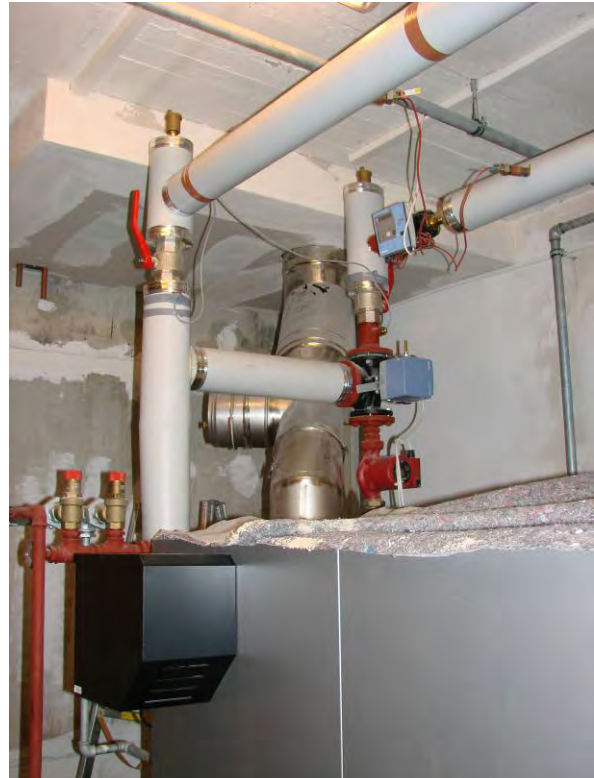
Messstellen WMZ VL & RL Heizkessel Quelle: AEE Intec
