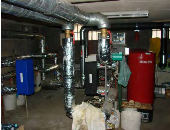
Fernwärmeübergabestation Quelle: AEE INTEC
