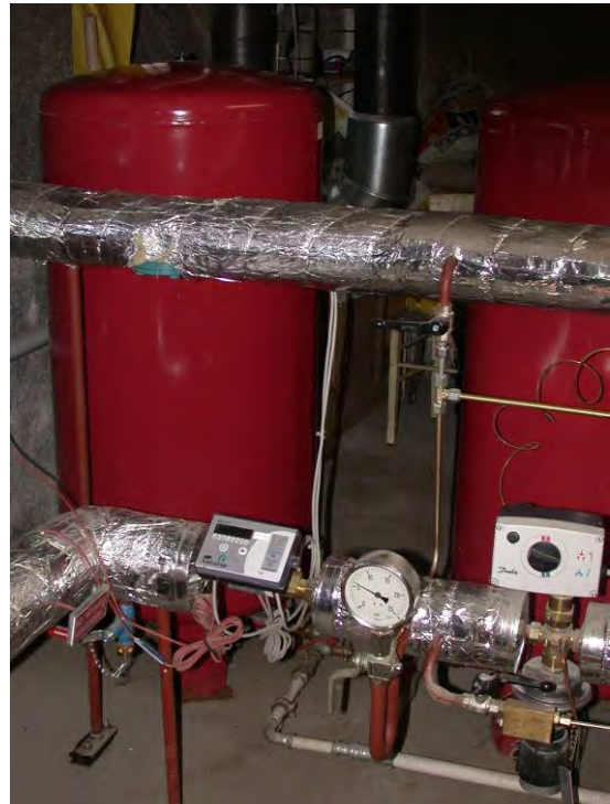
Wärmemengenzähler Warmwasser Quelle: AEE INTEC
