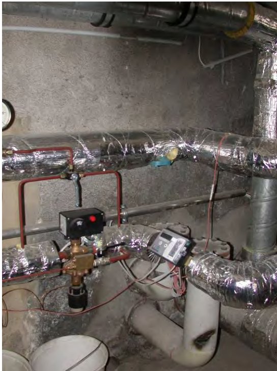
Wärmemengenzähler Heizung Quelle: AEE INTEC
