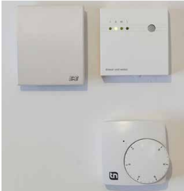
Abb. 3: Raumbediengerät zur Regelung von Heizung und Lüftung
