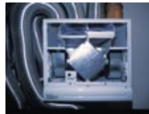
Lüftungsgerät mit Wärmetauscher
